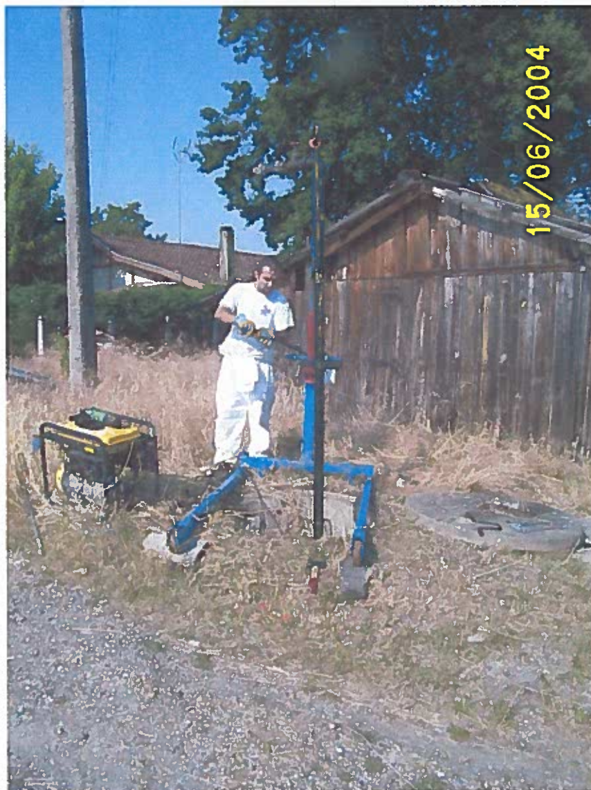
Figure n° 31 : Extraction de la pompe et de la colonne d'exhaure
