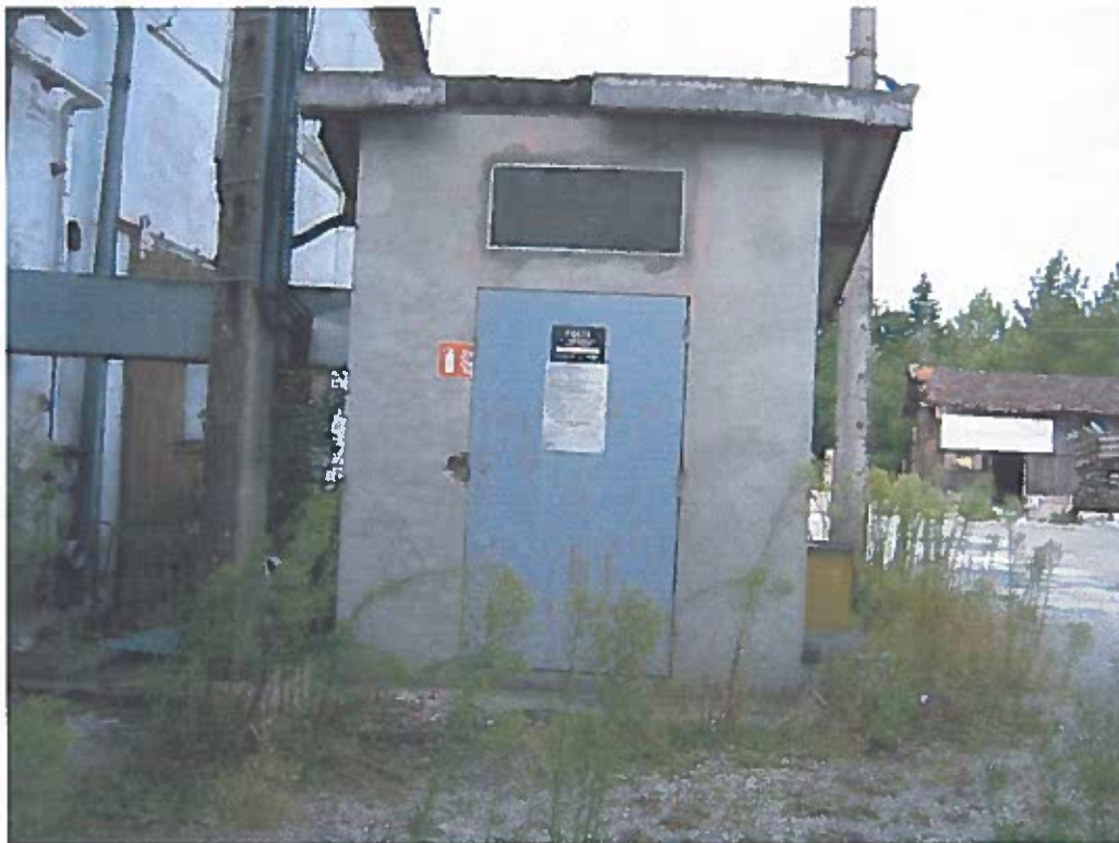
Figure n° 10 : Transformateur à côté du bâtiment 28
